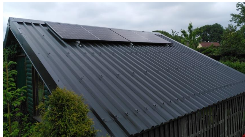
Installation auf Gartenhaus mit Trapezblech
